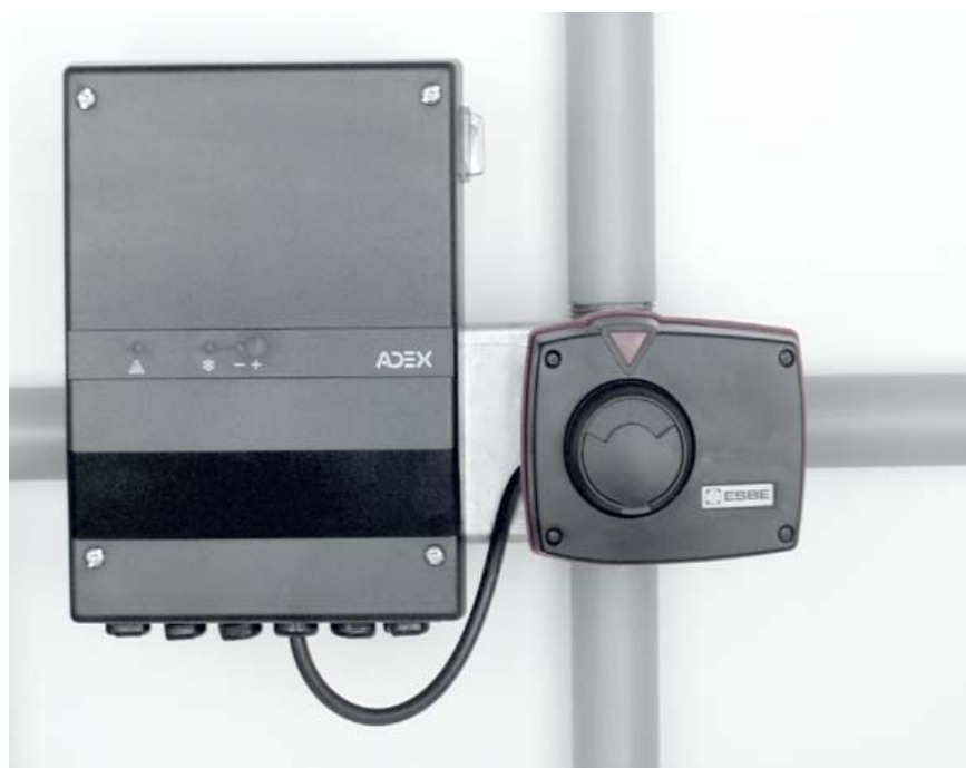
Obr. 8 Směšovací ventil ESBE se servopohonem a regulátorem upevněným na držáku.
